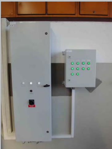
Schaltschrank mit sektionsweiser Bedienung mittels Tastern entsprechend Arbeitsbereichen
