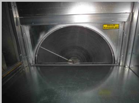
Nachrüstung von hocheffizienten Systemen zur Wärmerückgewinnung
