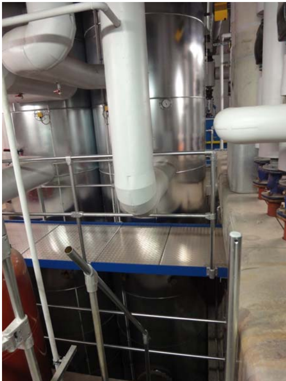
Foto 4: Schichtenspeicher 2 x 16.000 Liter, H = 9.000 mm
