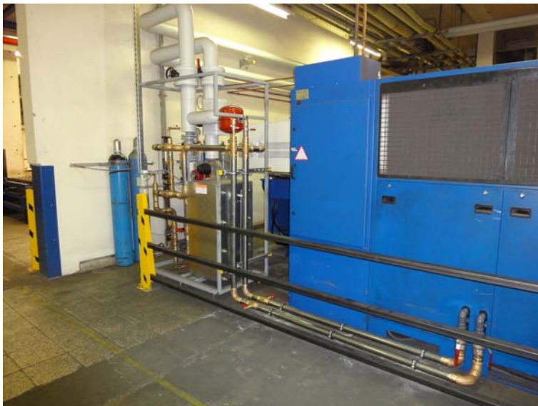
Foto 2: TRUMATIC L2530 mit Wärmeübertragerstation
