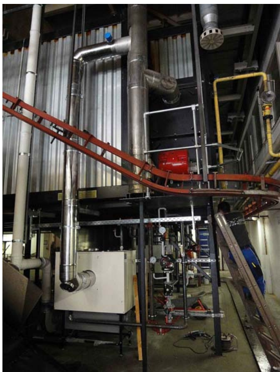
Foto 1: Einbindung der Wärmerückgewinnung mit Abgaskondensation an einem Einbrennofen
